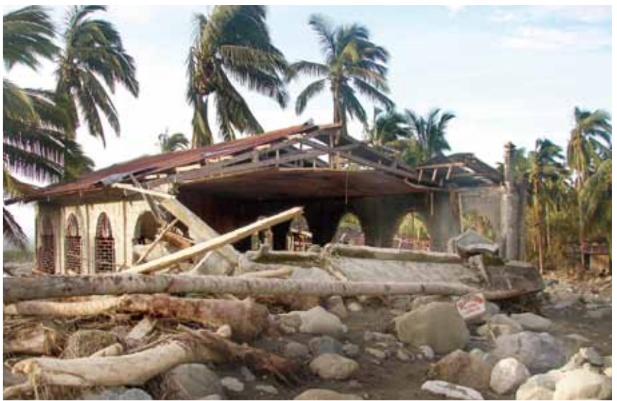
壊れた鉄筋コンクリート住宅が被害の大きさを示している
